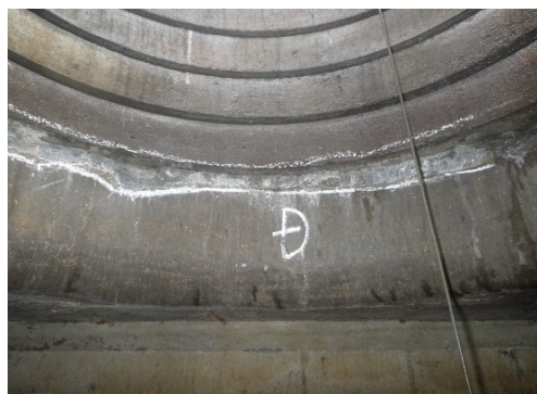
↓ 首部亀裂(剥離)部1
