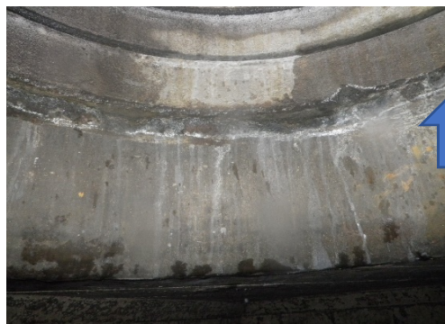
↓ 首部亀裂(剥離)部2
